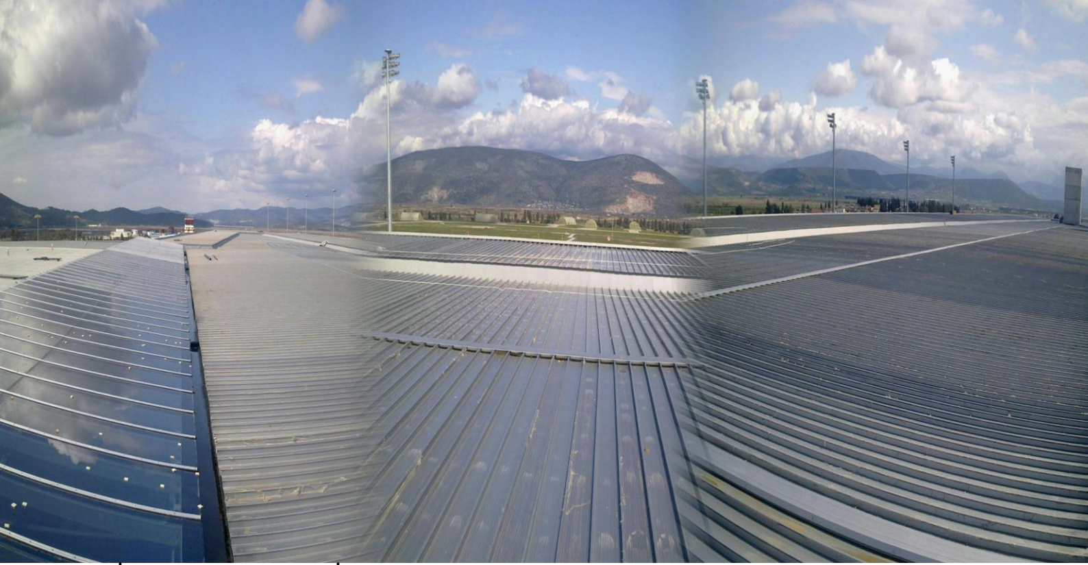
BODRUM / MİLAS ULUSLAR ARASI HAVA LİMANI /TERMİNAL ÜZERİ BOYALI TRAPEZ ÜZERİ TAŞYÜNÜ ÜZERİ 65/310 BOYALI ALÜMİNYUM KENET
